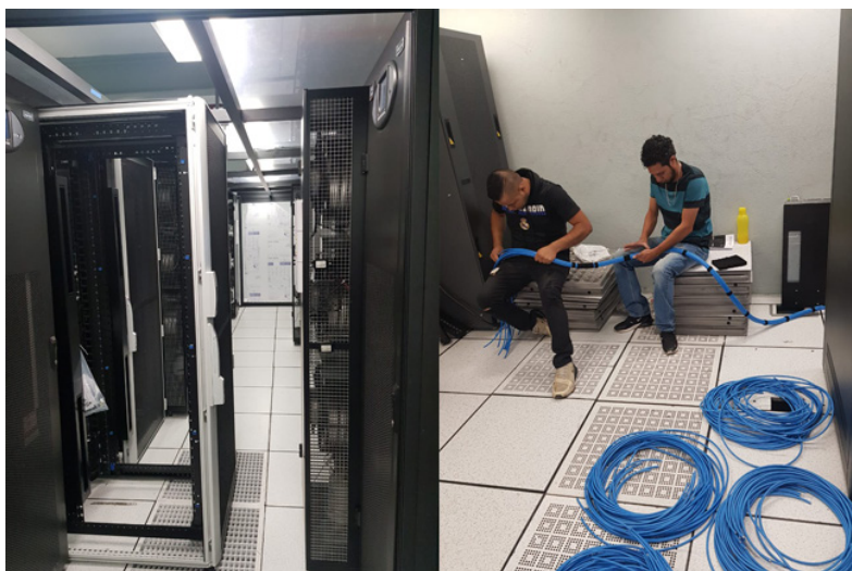
Imagen 2. Servicios on-premise. Fuente (DGTIC UNAM) https://www.tic.unam.mx/avance-del-70-en-implementacion-de-la-nube-de-la-unam-2/
